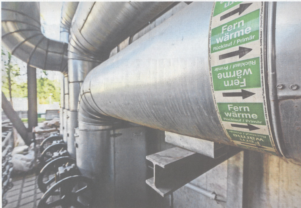
Die umweltfreundliche Fernwärme wird im Böblinger Restmüllheizkraftwerk gewonnen.
