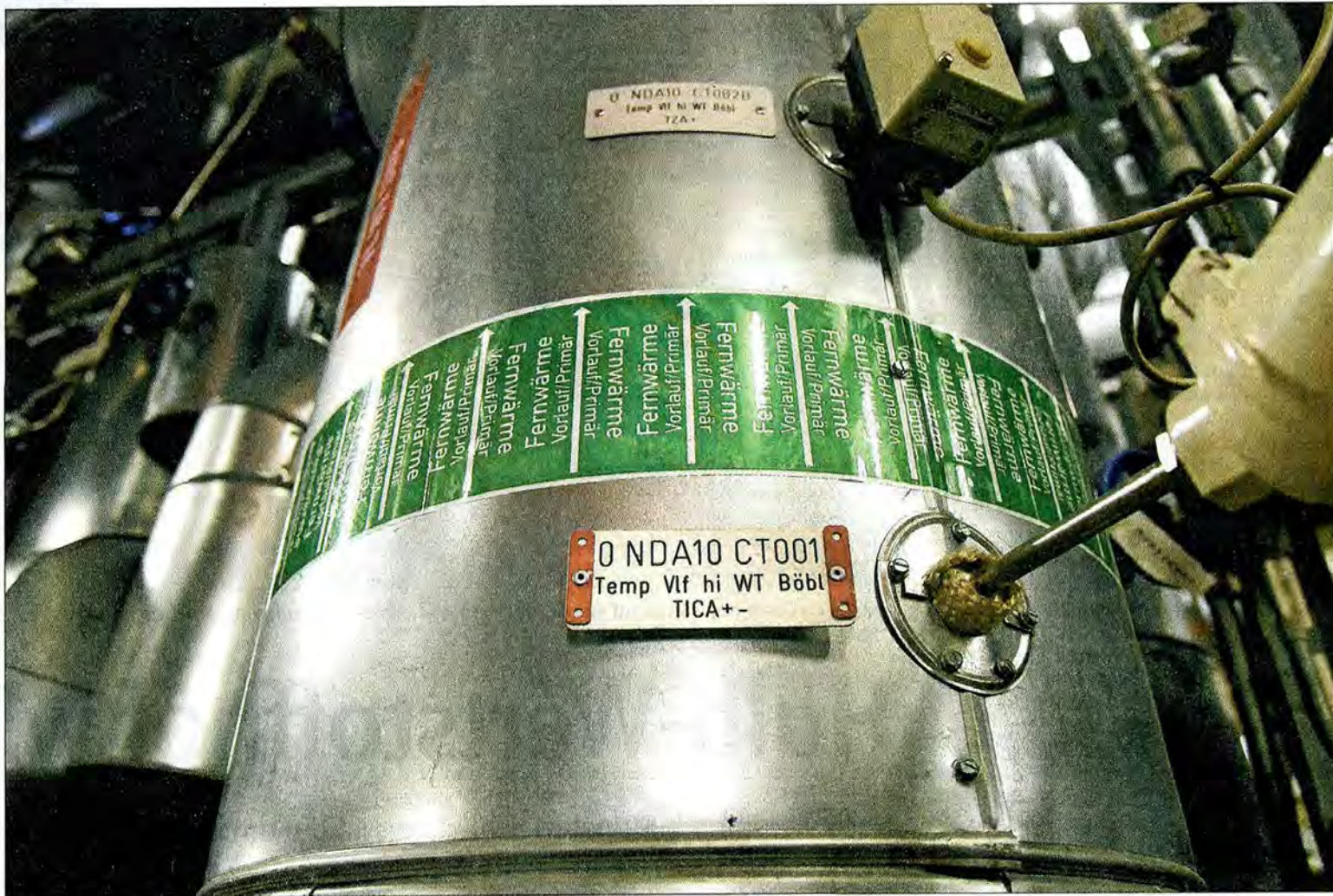
Die Fernwärme wird für die Böblinger im Schnitt zehn Prozent billiger. Die Stadtwerke wollen in Zukunft den Ausbau dieser klimafreundlichen Energie aus der Abwärme des Müllofens noch weiter ausbauen – auch um die Millioneneinbußen im Zuge des Mediationsverfahrens zu mindern Foto: Archiv
