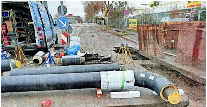
Etwa 1900 Anschlüsse versorgen die Stadtwerke Böblingen mit ihren Fernwärme-Leitungen.
