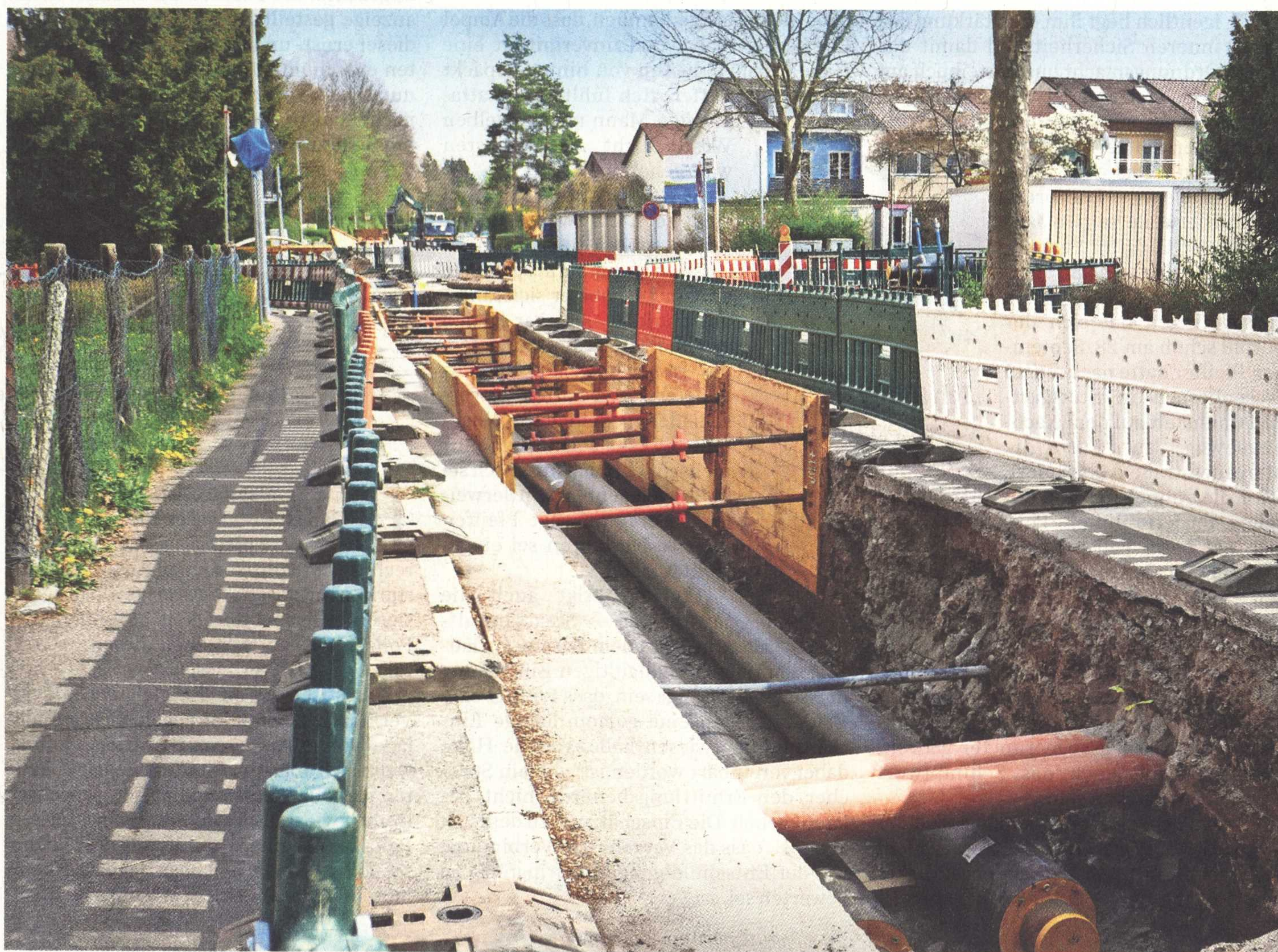
Der Auftrag war längst ausgeschrieben, die ersten Rohre lagen – doch die Stadtwerke behaupteten, es werde keine Leitung verlegt. Foto: Priebe
